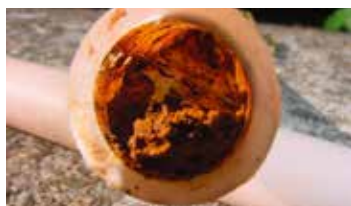
Verschlammte Fußbodenheizung: Schnitt durch ein Fußbodenrohr zeigt Eisenoxidschlamm.
