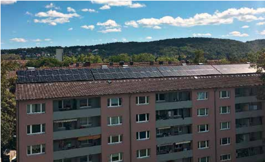
Ein Mehrfamiliengebäude im Smarten Quartier Karlsruhe-Durlach. Auf dem Dach wurde eine PV-Anlage mit 60 kWp Leistung installiert.
