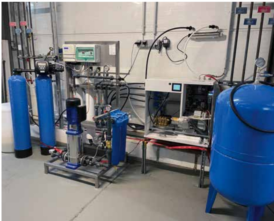
Pumpenstation für die adiabate Befeuchtung im Klimakanal mit Wasseraufbereitung.
