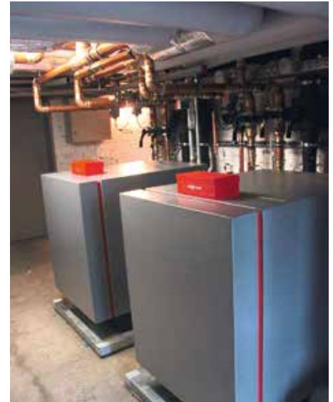
Die Wärmepumpenhydraulik des HEAVEN-Systems nutzt die Synergien von Luft (Verfügbarkeit, Kosten) und Erdwärme (Temperaturen, Effizienz) und löst das Problem der begrenzten Flächen in Städten.
