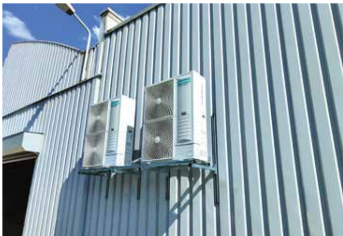
An der Fassade montierte PAC Außeneinheiten von Hisense.
