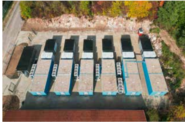
VRF-Außeneinheiten von Panasonic zur Klimatisierung der Batteriespeicheranlage.
