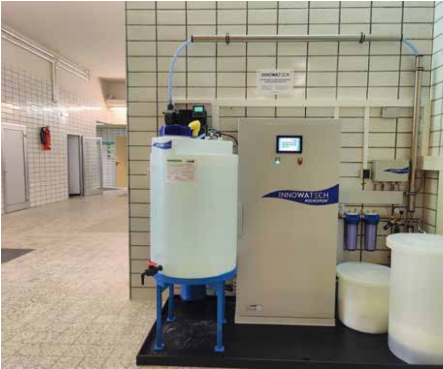
INNOWATECH Aquadron® ECO im Wasserwerk.
