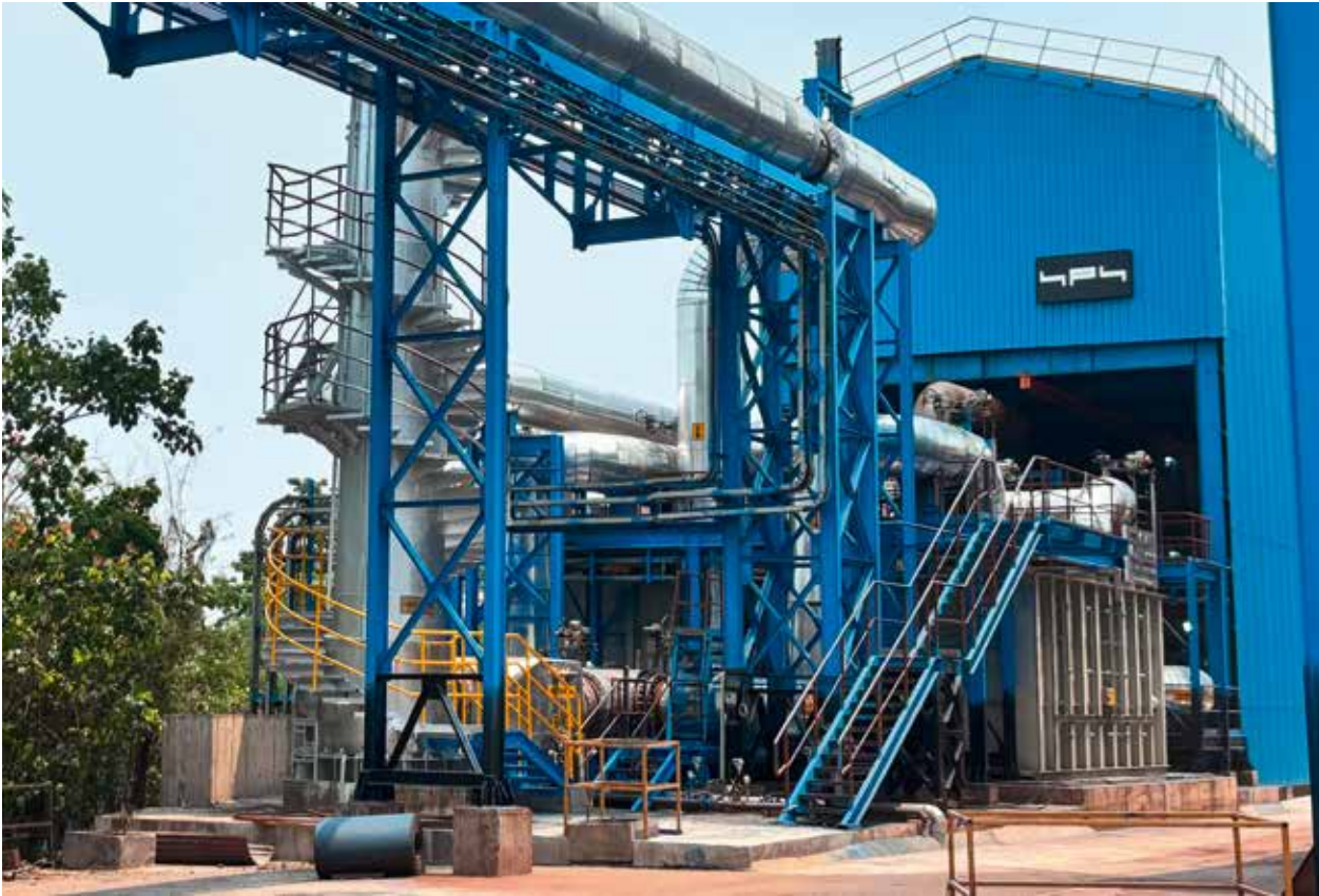
Eine von zwei Kraftblock-Einheiten des Thermal Storage Systems bei Tata Steel.
