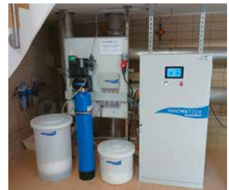
INNOWATECH Aquadron ECO im Wasserwerk.
