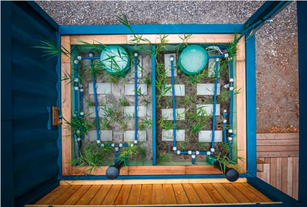
Modularer Container-Bodenfilter mit Rohrleitungssystem, Filtermedium und Schilfbepflanzung zur dezentralen Wasseraufbereitung.
