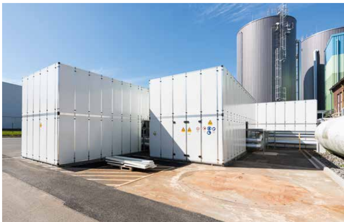
Blick auf Einhausung der 4 Luft-Wasser-Wärmepumpen.
