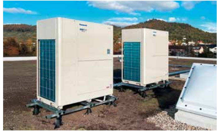
Panasonic ECOi Außeneinheiten zur CO 2 -optimierten Beheizung des Gebäudekomplexes
